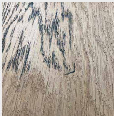
Rys. 1: Wizualizacja przebarwień w drewnie otwartoporowym, spowodowanych wilgocią (widoczne dzięki użyciu roztworu żelaza).
